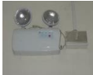
LUMINARIA DE EMERGENCIA
