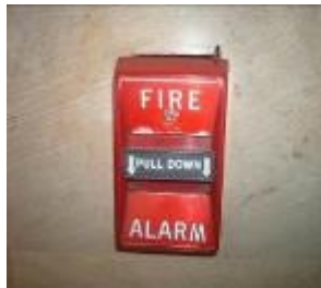
PALANCA DE INCENDIO
